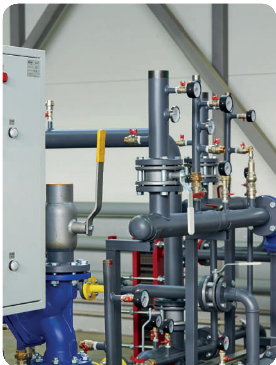
ИНДИВИДУАЛЬНЫЙ ТЕПЛОВОЙ ПУНКТ
